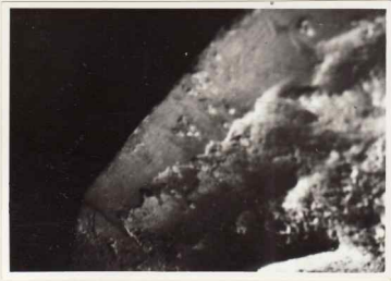
34. Urme de tencuială păstrate sub zidăria supraînălțată a pragului nou. Aereastra absidei
