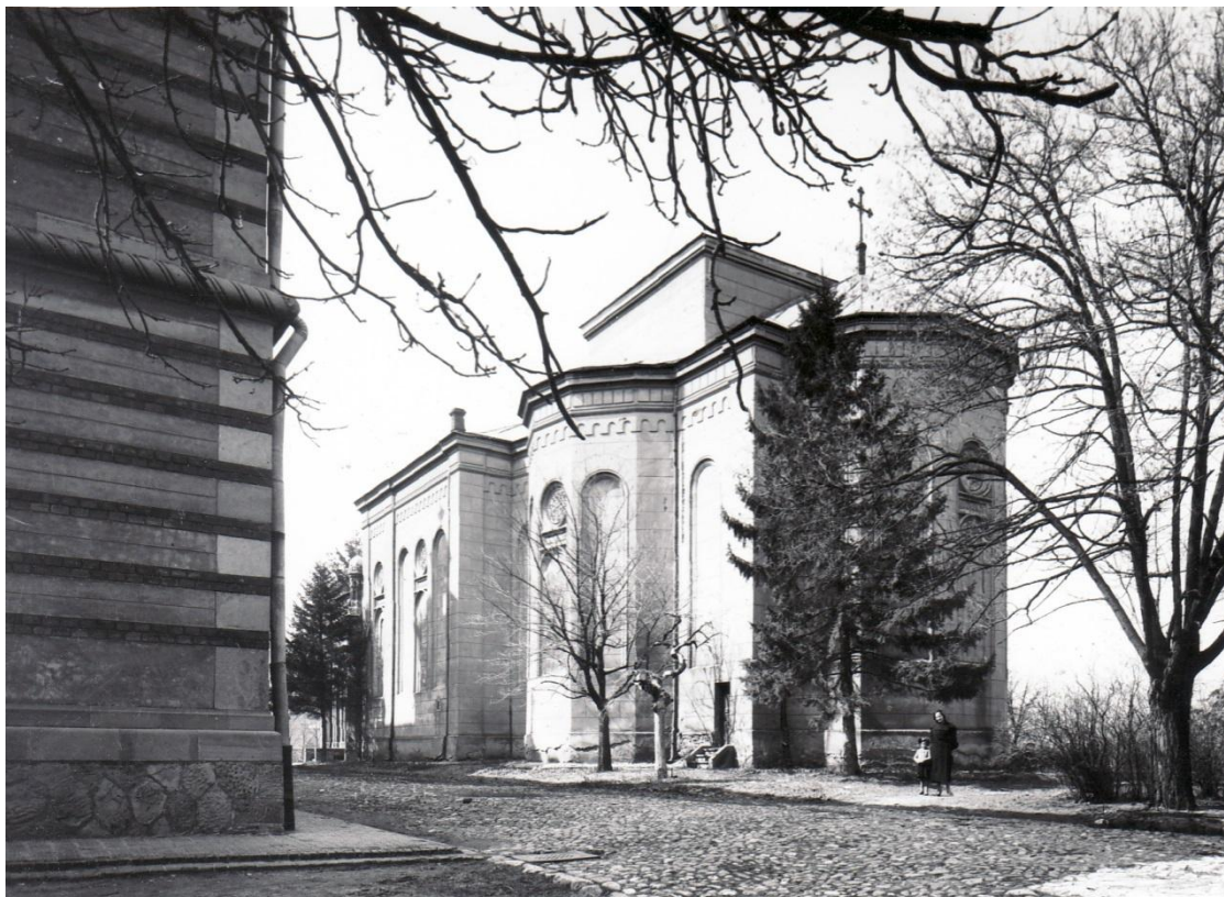
vedere sud est înainte de restaurare, foto arh. A. Petit, 1930, Arhiva INP, fond CMI;
